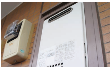
ガス燃焼装置の微小電流測定に DCμA レンジ
