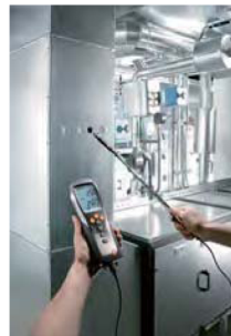
プラントのダクト内風速・風量
